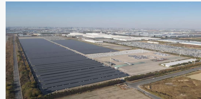
江苏悦达起亚第三工厂光伏系统
